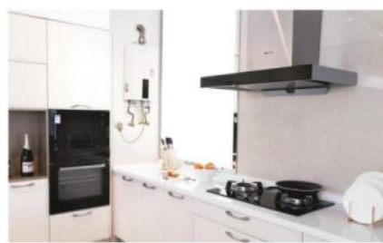
室内燃气热水器泄露监测
