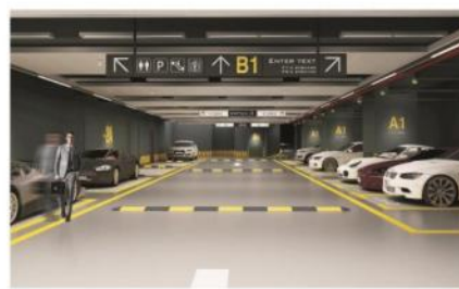
地下停车场CO监测
